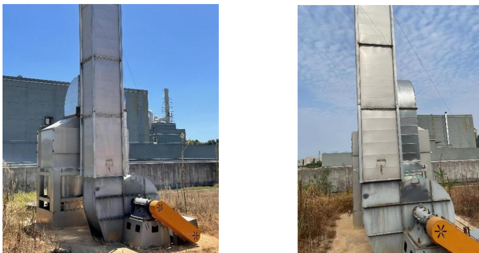
图 3.1.4-1 生物反应车间排气筒废气采样口设置情况
